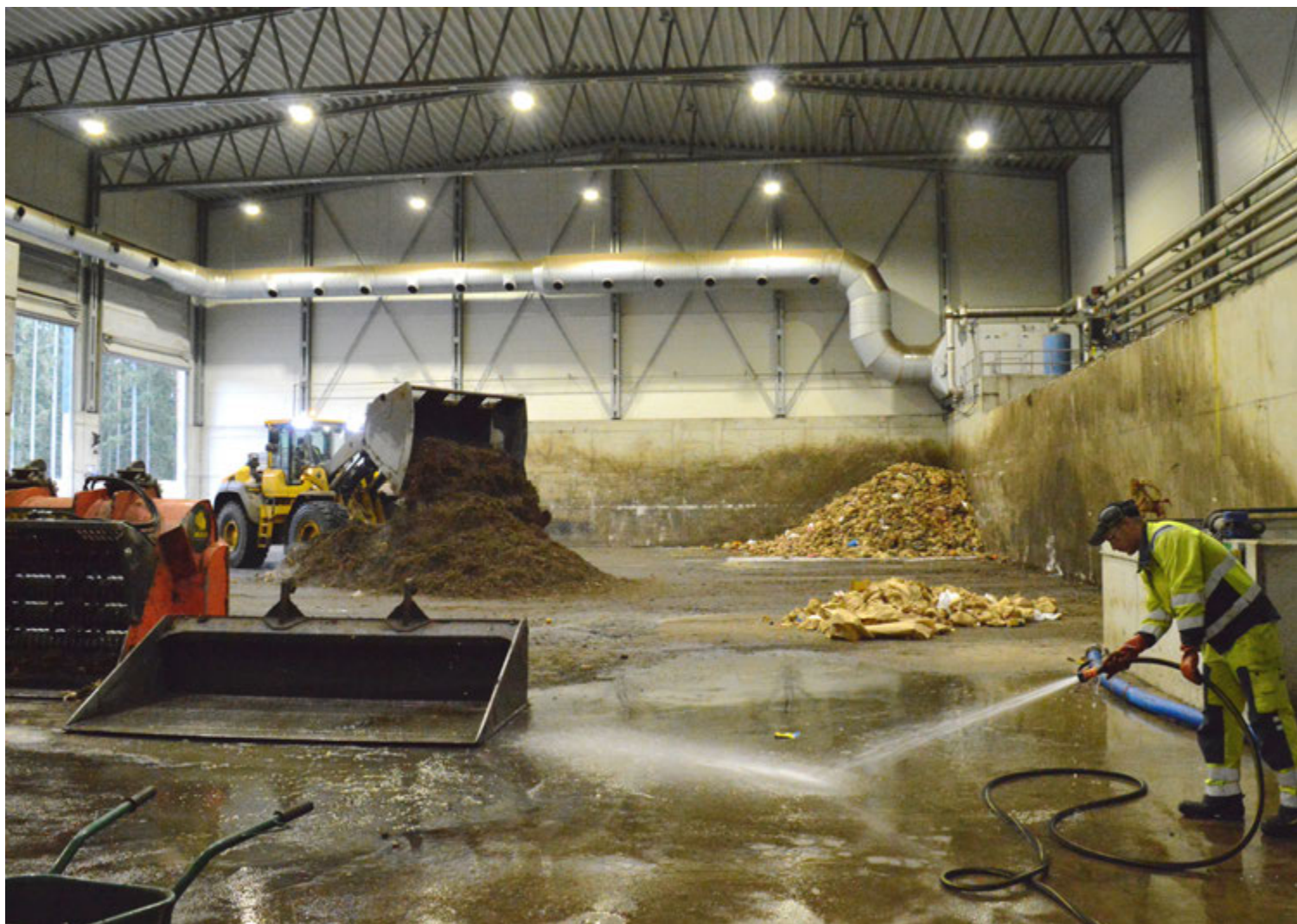
En grävsopka kör in trädgårdsavfall bredvid en stor hög bruna kompostpåsar. Alltihop blandas med fettslam i en plugg som blir gas och gödsel i rötkammaren.
